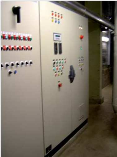
Contrôle commande Fives Pillard type "Gensafe"
