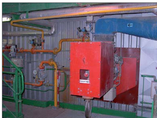
Fig.5 : PILLARD "GROOM" burner AZALYS plant at Carrière sous Poissy (France)
